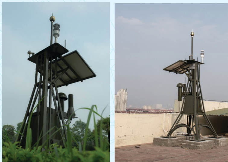
Hình 3. Thiết bị được lắp đặt tại Viện Hoá học Môi trường quân sự
