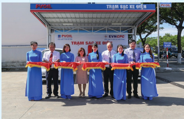
Trạm sạc được lắp đặt tích hợp tại cửa hàng xăng dầu - Buổi khánh thành đưa vào sử dụng trạm sạc tại vị trí cửa hàng xăng dầu tại Đà Nẵng với đại diện Tổng công ty Điện lực miền Trung - Tổng công ty Dầu Việt Nam - Sở Công Thương thành phố Đà Nẵng ngày 02/07/2020
